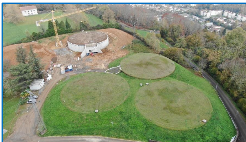
Figure 6. Site de Guindalos : Nouveau réservoir de 5 000 m 3
